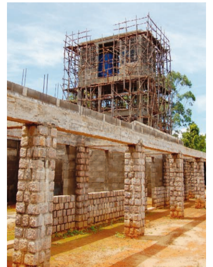
Le château d'eau d'une capacité de 20 000 litres sera relié au forage réalisé à 46 m de profondeur et sera alimenté par une pompe solaire.
