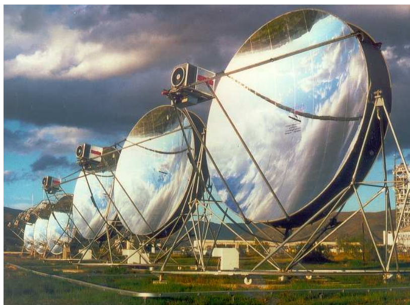
Batterie de générateurs stirling solaires
