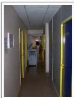
21 - Couloir de la ZT sans éclairage
