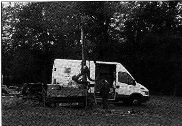
Forage illégal sur le site.
