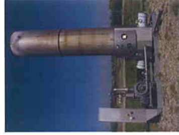
Exemple d'unité de combustion
