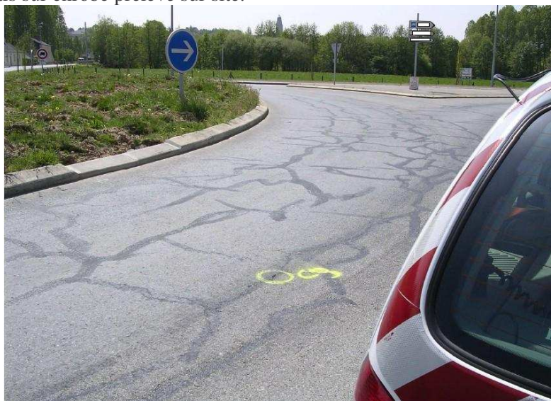
L'enrobé présente de la fissuration anarchique. Des carottes réalisées sur les fissures (marque jaune) permettent de vérifier que la fissuration provient de la surface.
