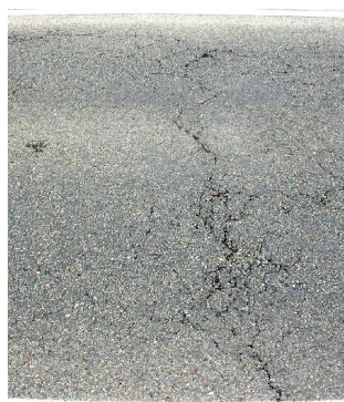
Fissure de retrait ramifiée et faïencée
