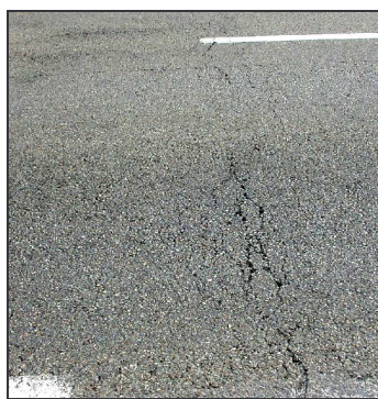
Fissure de retrait dédoublée
