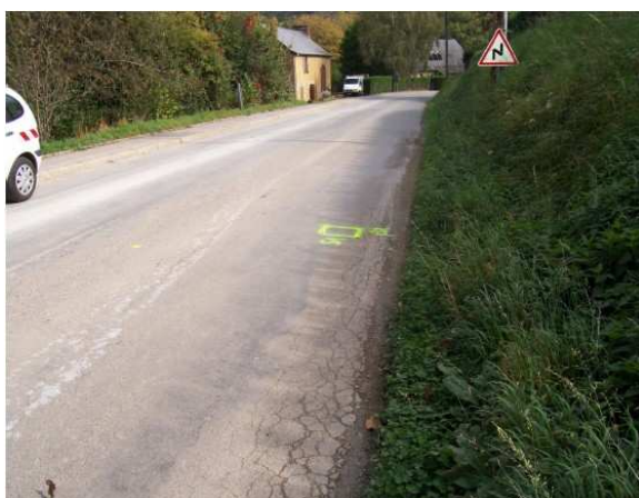
L'absence de fossé empêche l'eau de s'écouler hors de la chaussée.
