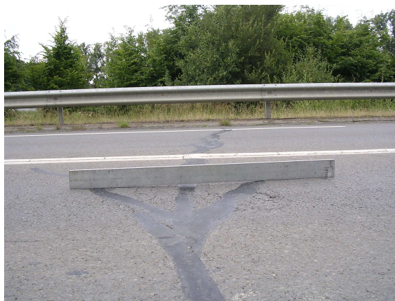
Exemple de FT affaissées (PO)
