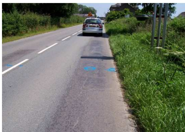
Les accotements non dérasés empêchent l'eau de s'écouler hors de la chaussée.
