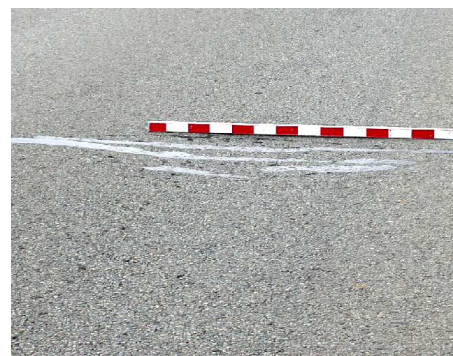
Fissure transversale colmatée, faïencée et affaissée
