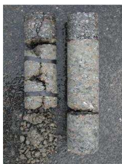
Carottes sur fissure de retrait et en centre de dalle
