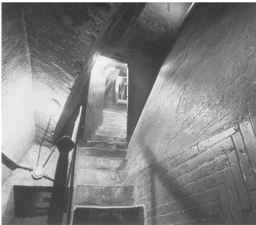
Figure 16. Quand on monte les escaliers à l'intérieur du dôme, on constate que, sur plusieurs endroits, les motifs de la maçonnerie ont été volontairement laissés visibles.
