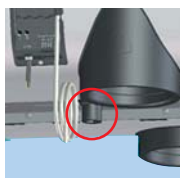
Evacuation permanente des condensats
