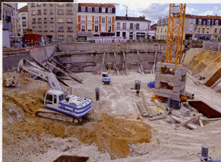
Le «cratère», qui sera recouvert par la dalle avant la fin de l'année
