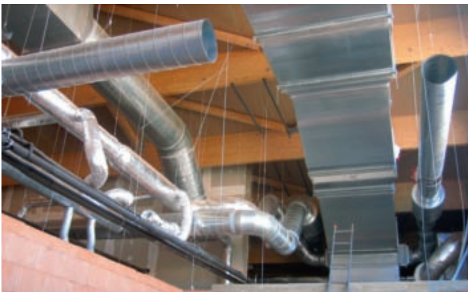
Climatisation et ventilation mécanique
