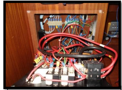
Le tableau électrique en 12 V
