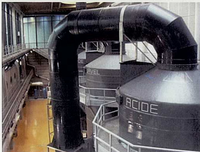
Photo de l'unité de désodorisation
