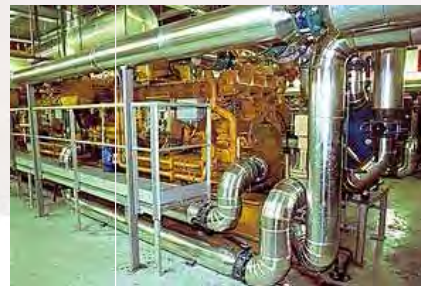
Géothermie « basse énergie » La Courneuve (1993)
