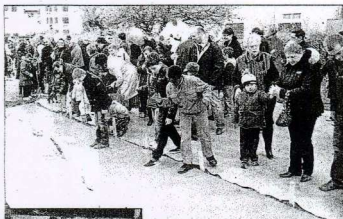
Les enfants et habitants du quartier ont laissé leurs empreintes de pas ou de main sur la dalle en béton frais.
